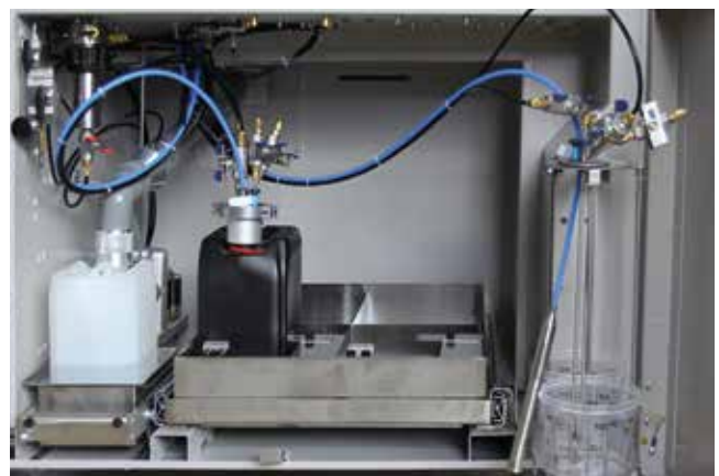
Leicht zugängliche Lackbevorratung an der Anlagenrückseite
